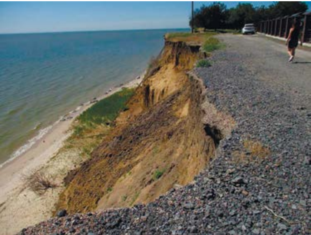
Фото 1.4.2.7. Абразионный береговой склон и свежие обвалы грунта на участке в районе 6-го переулка, с. Петрушино, Неклиновский район Ростовской области.
