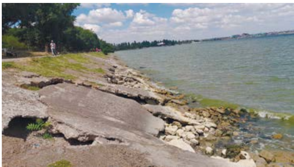
Фото 1.4.2.37. Разрушение берегозащитной стенки из-за отсутствия пляжеудерживающих сооружений.
