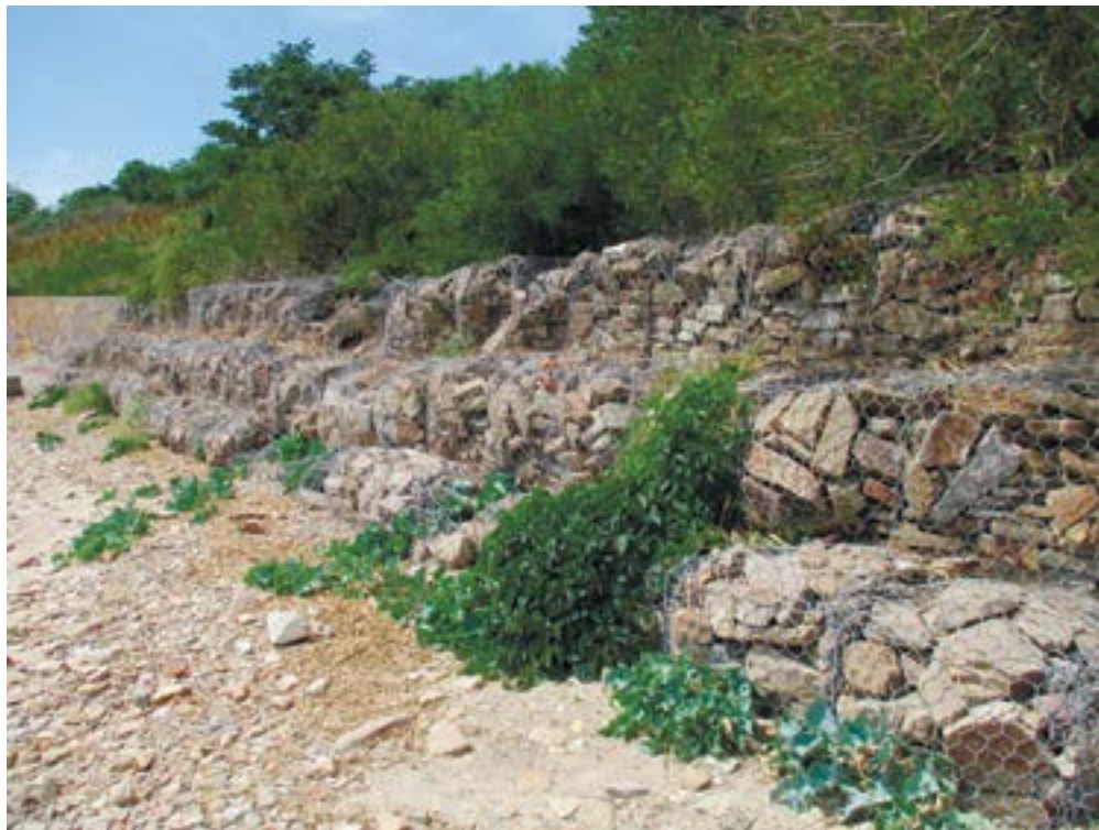
Фото 1.4.2.36. Частично разрушенная подпорная стенка из габрионных конструкций в районе Детской многопрофильной больницы.
