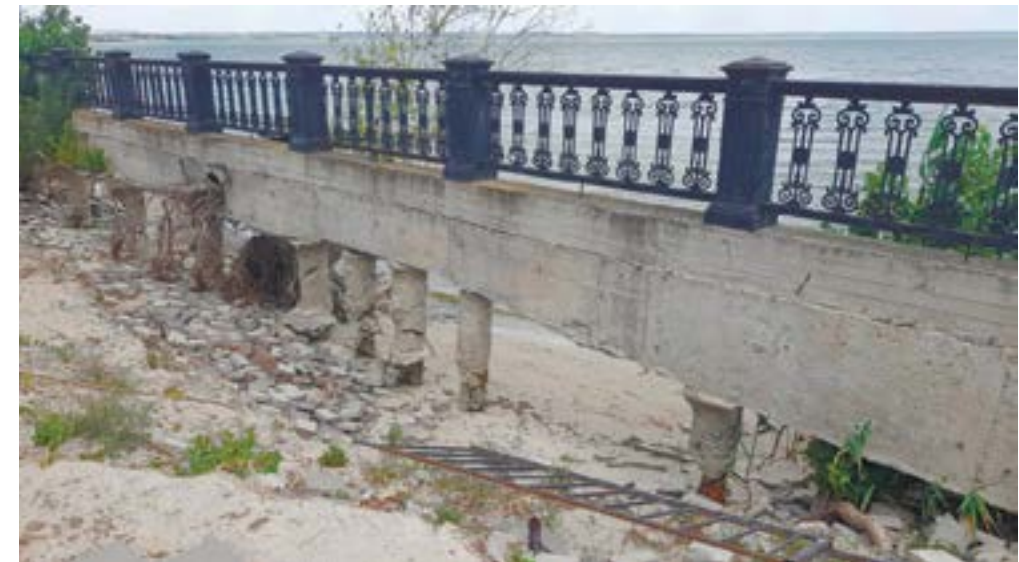
Фото 1.4.2.38. Разрушенное берегоукрепление на Пушкинской набережной.
