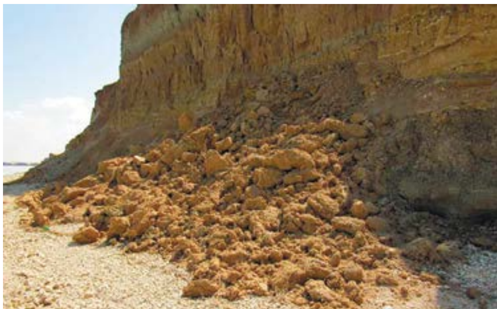
Рис. 6. Обвал в 3 км к северо-востоку от станицы Жуковская. Дубовский район.
