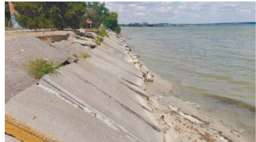
Фото 1.4.2.39. Разрушенное берегоукрепление на Пушкинской набережной.
